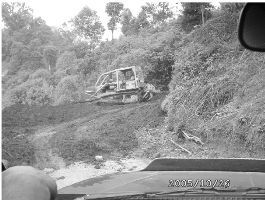
Fotografía 14 Municipio de San Juan Ostuncalco, Departamento de Quetzaltenango. Desbloqueo de la carretera a Las Barrancas Octubre, 2005
