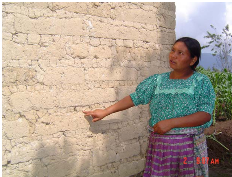
Fotografía 1 San José Chacayá - Sololá Caserío Villa Linda Paso de la tormenta Stan, daños a viviendas Año 2006
