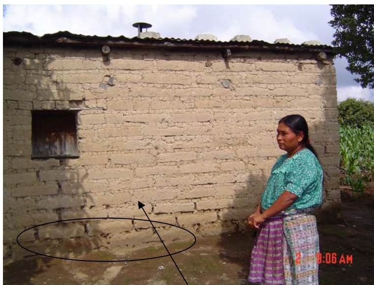
Fotografía 2 San José Chacayá - Sololá Caserío Villa Linda Paso de la tormenta Stan, daños a viviendas Año 2006
