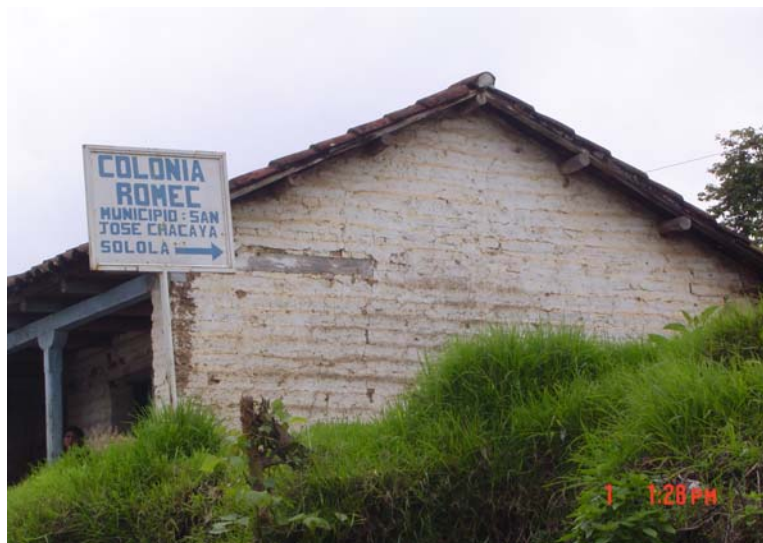
Fotografía 11 San José Chacayá - Sololá Colonia Romec Vulnerabilidad física Año 2006
