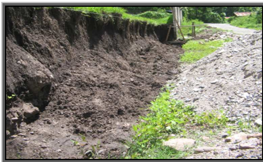
Imagen 1 Municipio de San Diego, Departamento de Zacapa Derrumbes en Carretera que Conduce a la Aldea La Ensenada Año: 2006
