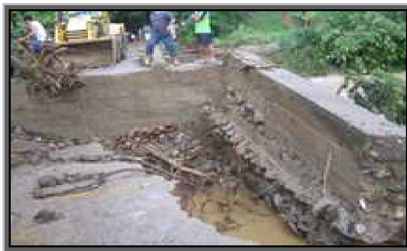
Imagen 10 Municipio de San Diego, Departamento de Zacapa Aldea Santa Elena, Destrucción de Puentes Año: 2006
