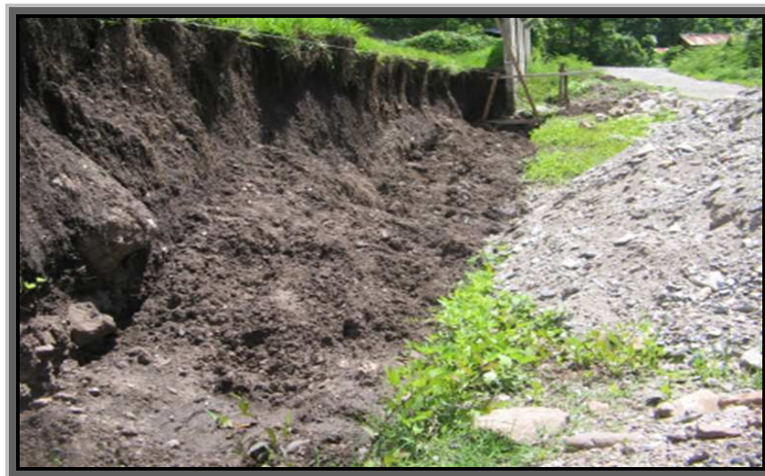
Imagen 1 Municipio de San Diego, Departamento de Zacapa Derrumbes en Carretera que Conduce a la Aldea La Ensenada Año: 2006
