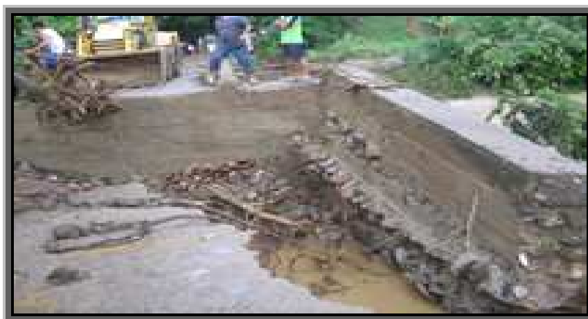
Imagen 12 Municipio de San Diego, Departamento de Zacapa Aldea Santa Elena, Destrucción de puentes Año: 2006
