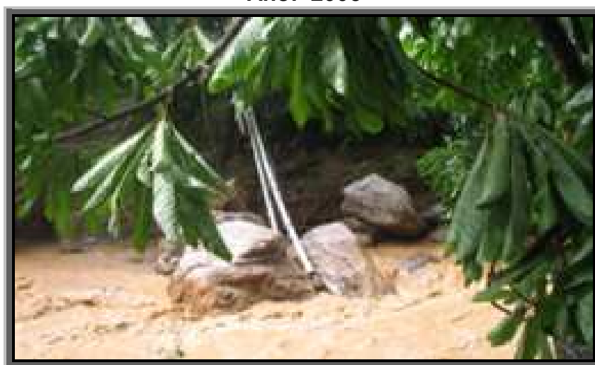
Imagen 10 Municipio de San Diego, Departamento de Zacapa Aldea Venecia, Destrucción de tuberías de agua potable Año: 2006
