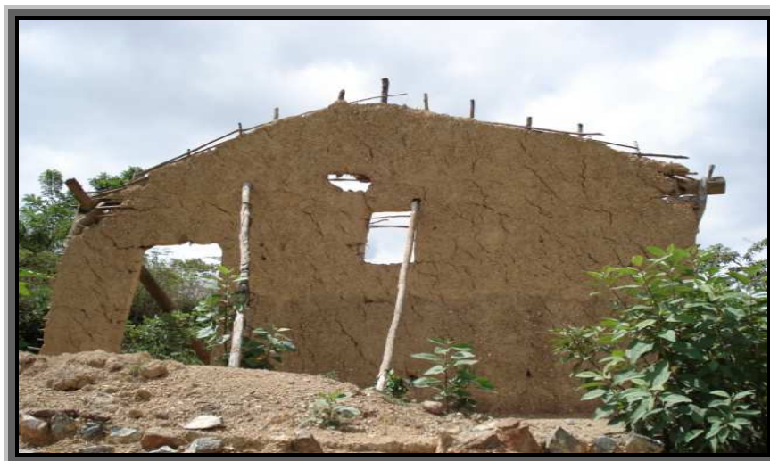
Imagen 4 Municipio de San Diego, Departamento de Zacapa Caserío las Delicias, Construcción en Zonas Inestables Año: 2006
