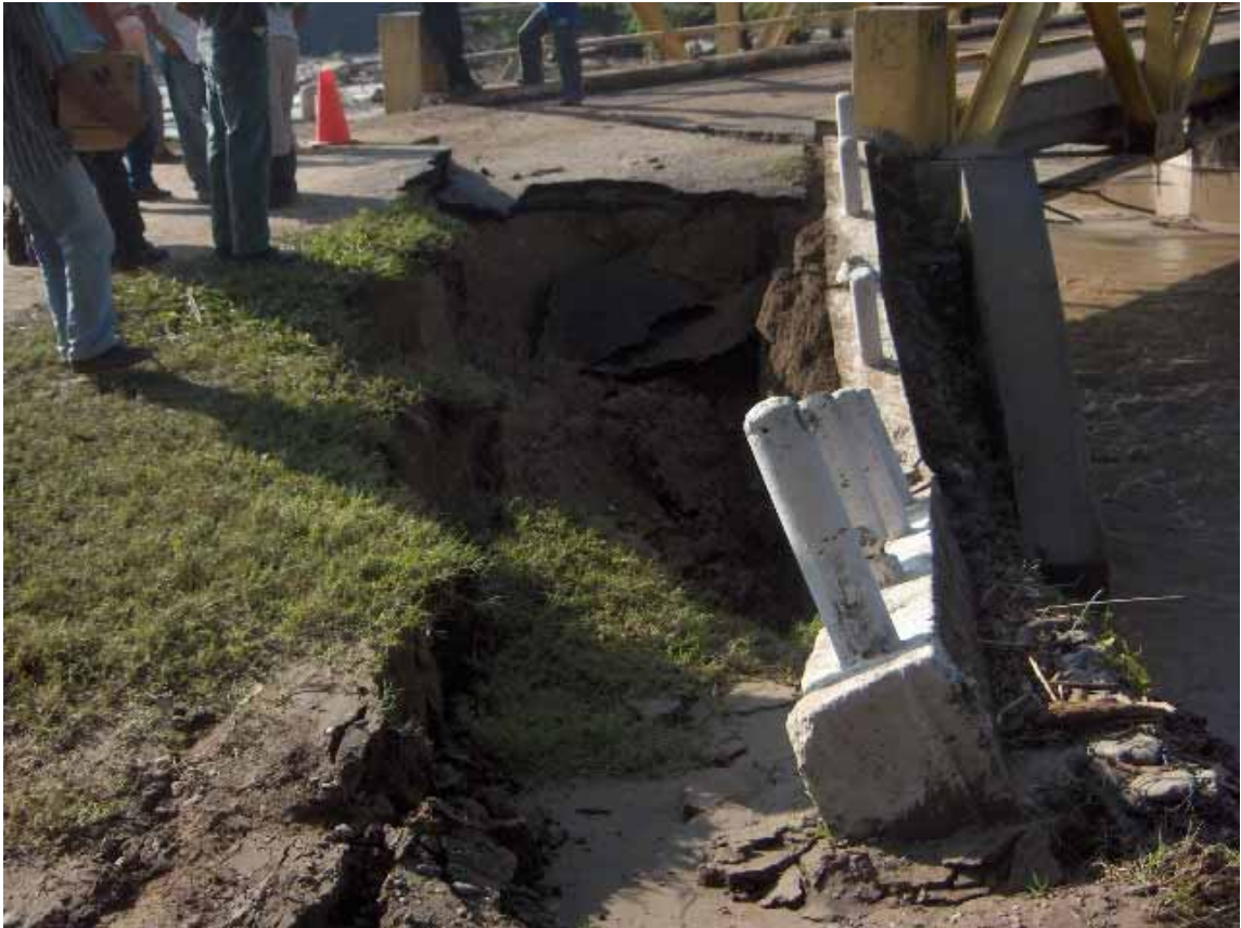
Foto 1 Municipio de Gualán – Zacapa Daños en Puente sobre el río Naranjo Año: 2006
