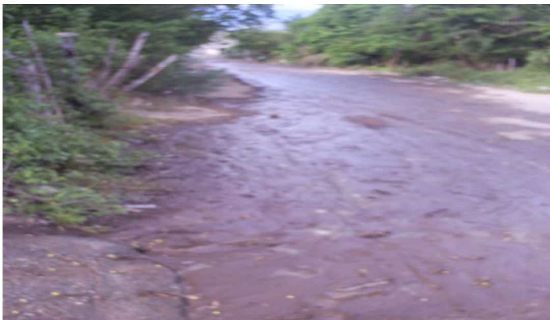
Figura 12 Municipio de Estanzuela - Departamento de Zacapa Daños causados por el Huracán Mitch Año: 2006
