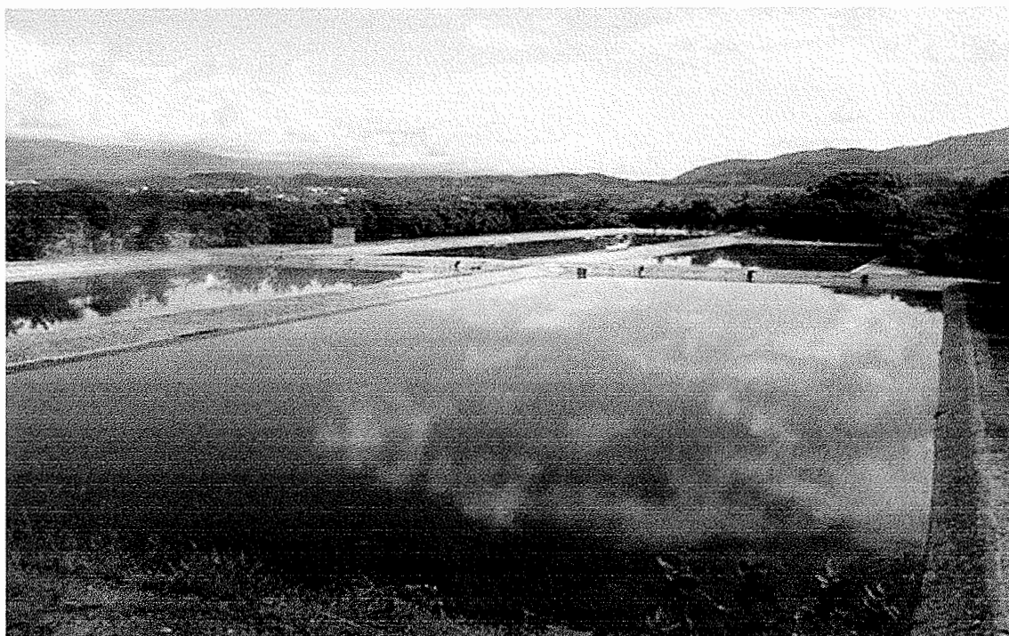
Figura 18 Municipio de Estanduela - Departamento de Zacapa Planta de Tratamiento de Agua Año: 2006
