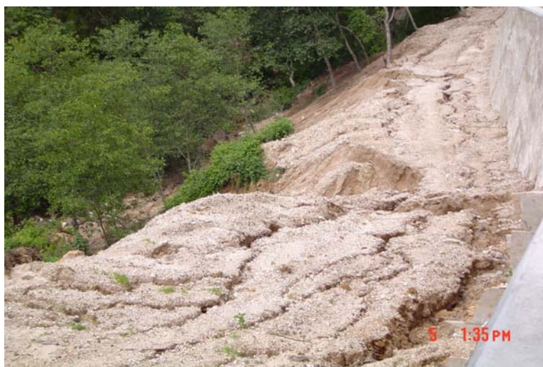
Fotografía 4 San José Chacayá - Sololá Caserío Chuimanzana Deslizamientos de tierra Año 2006
