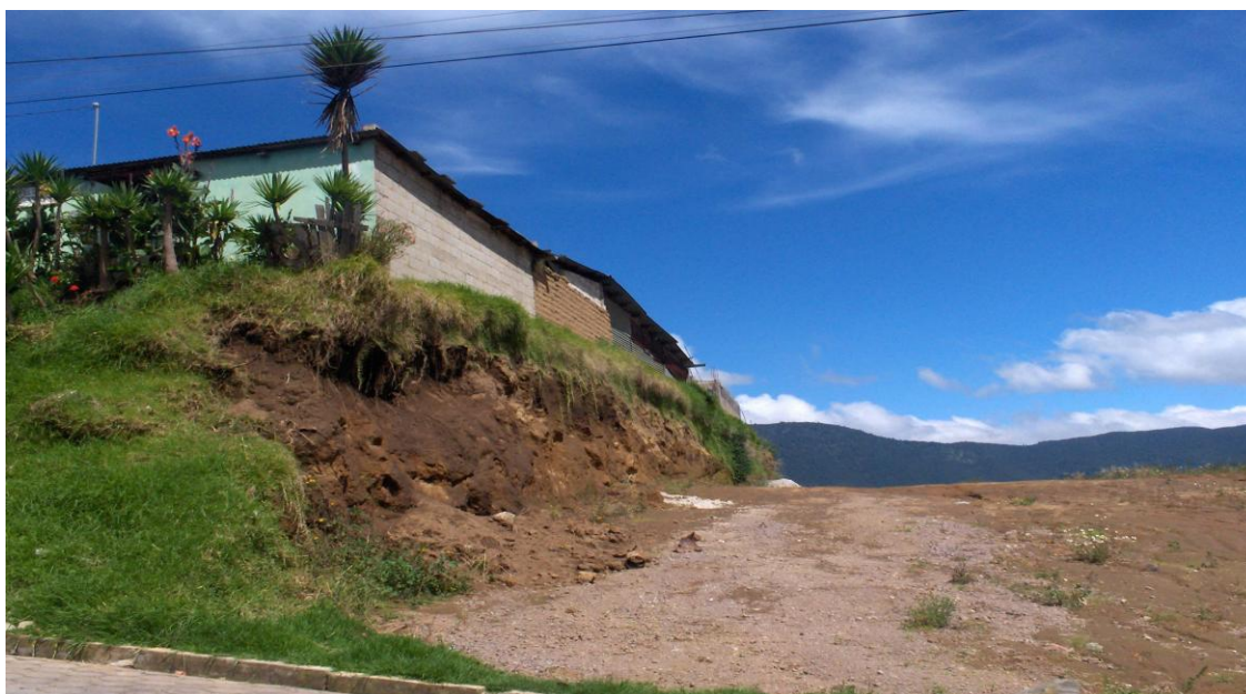
Figura 9 Municipio La Esperanza – Quetzaltenango Amenazas de Deslizamientos Año: 2005
