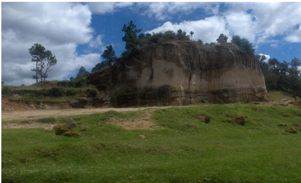
Figura 14 Municipio La Esperanza – Quetzaltenango Amenazas de Derrumbes Año: 2005
