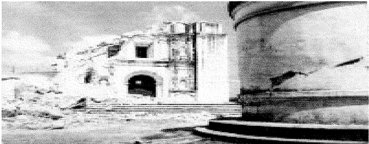
Figura 12 Municipio de Estanzuela – Departamento de Zacapa Daños causados por el terremoto de 1976. Año: 2006
