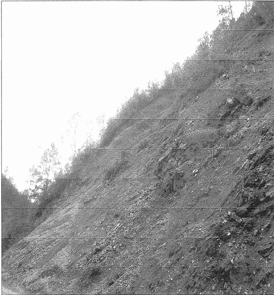
Fotografía. No. 1 Aldea Salquil Grande-Nebaj, Quiché. Deslizamiento : Año: 2008
