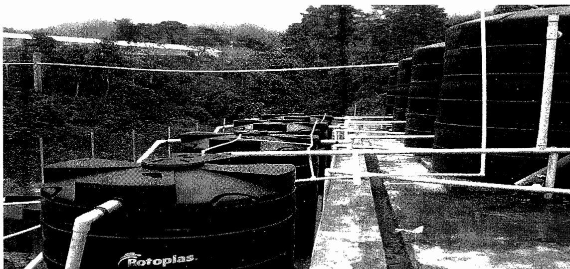
Fotografía 5 San Antonio Sacatepéquez – San Marcos Planta para minimizar la contaminación de aguas negras Año: 2009
