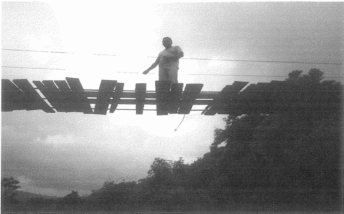
Fotografía 4 Puentes de hamaca dañados
