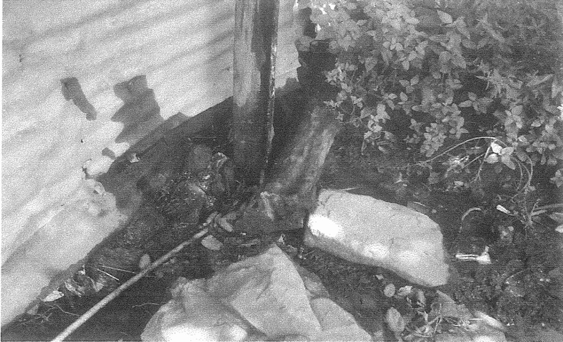
Fotografía 3 Falta de drenajes
