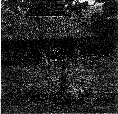
Malas condiciones en escuela, techo dañado.
