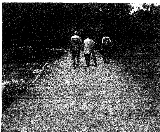
Construcción inadecuada de puente
