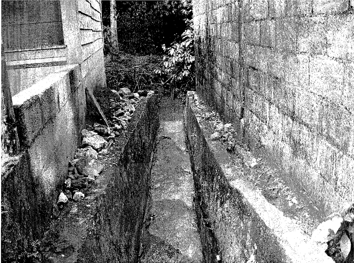
Fotografía 4 Municipio de La Reforma, Departamento de San Marcos Falta de drenajes Año 2010
