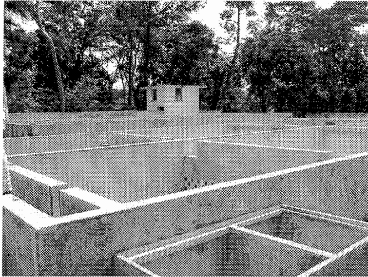
Planta de tratamiento de agua. Cantón Las Flores
