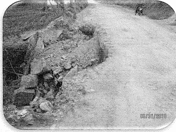
Figura 3. Tramo dañado durante la tormenta Agatha 2010, en la carretera que conduce de la cabecera municipal a la aldea Rodeo.
