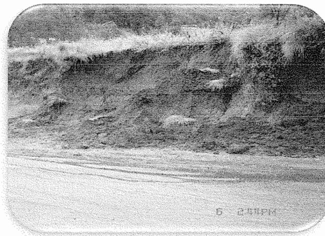
Figura 2. Derrumbe en la carretera que conduce de la cabecera municipal a la aldea Rodeo.
