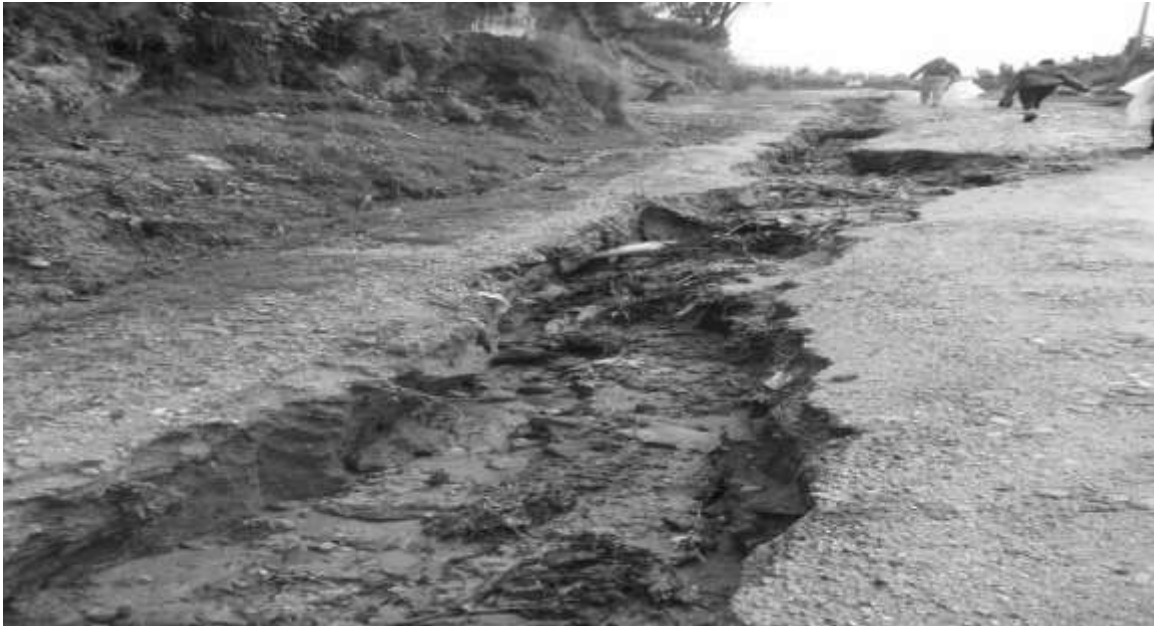
Fotografía 7 Grietas en carretera
