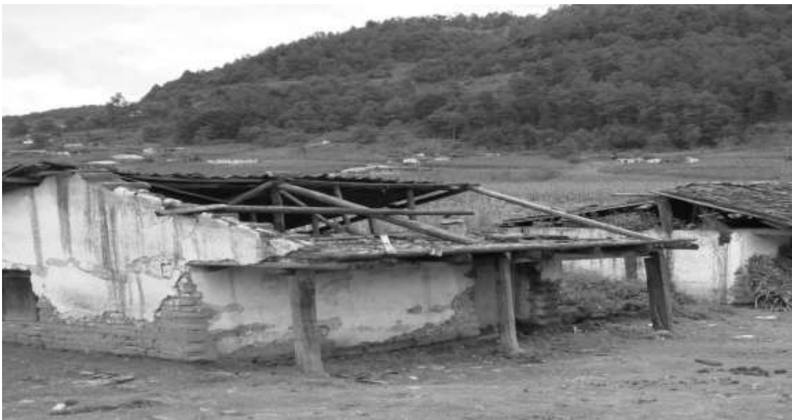
Fotografía 2 Viviendas con materiales no resistentes
