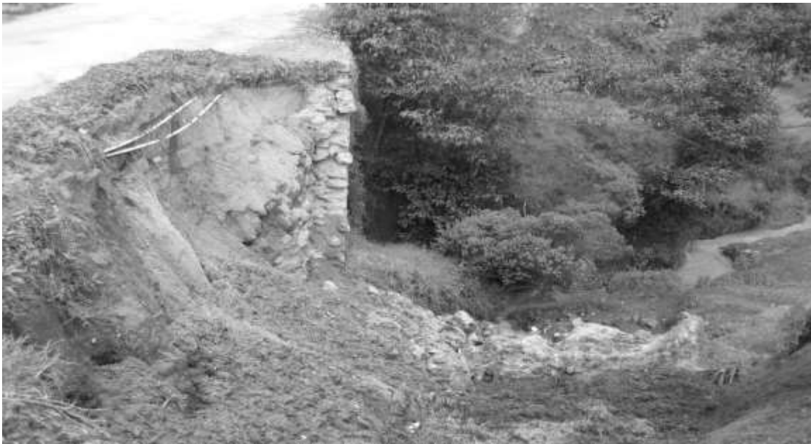
Fotografía 6 Deslizamiento y derrumbe
