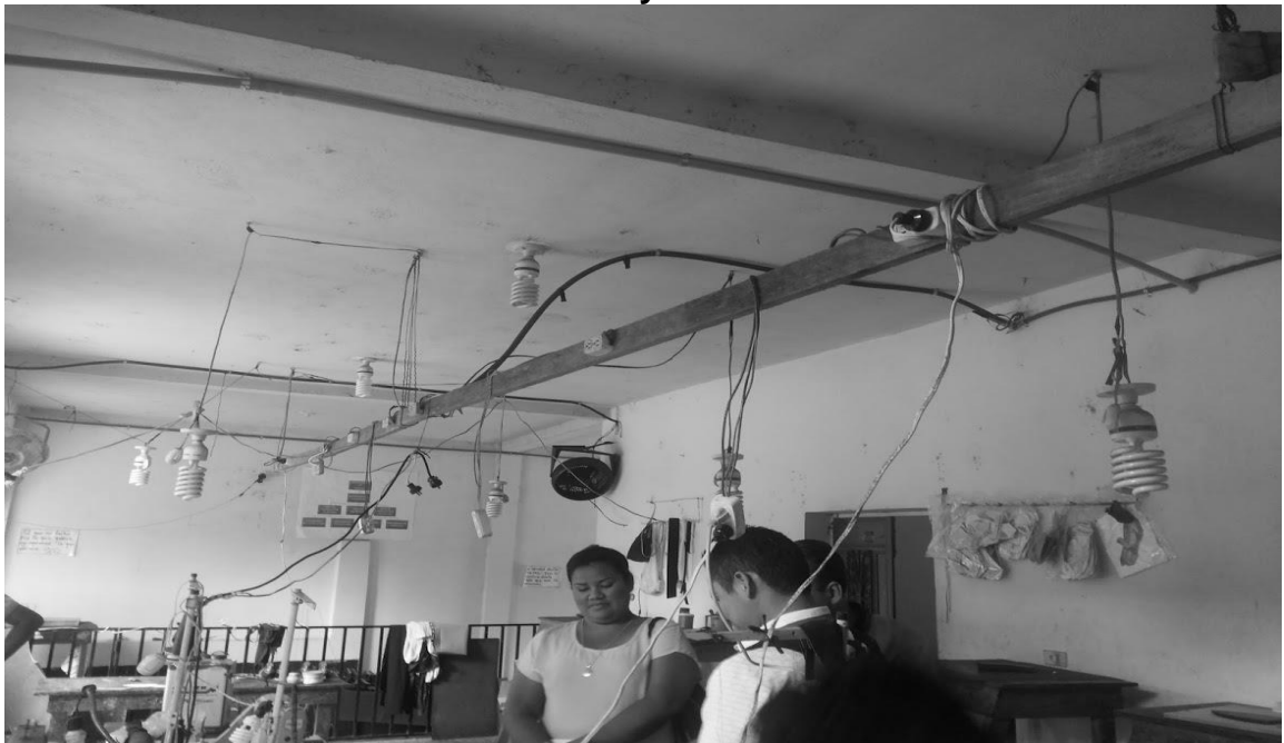
Figura 20 “INDUSTRIA Y COMERCIALIZADORA “K’TOCALZA” Sistema de iluminación y conexiones eléctricas en el área de corte y costura
