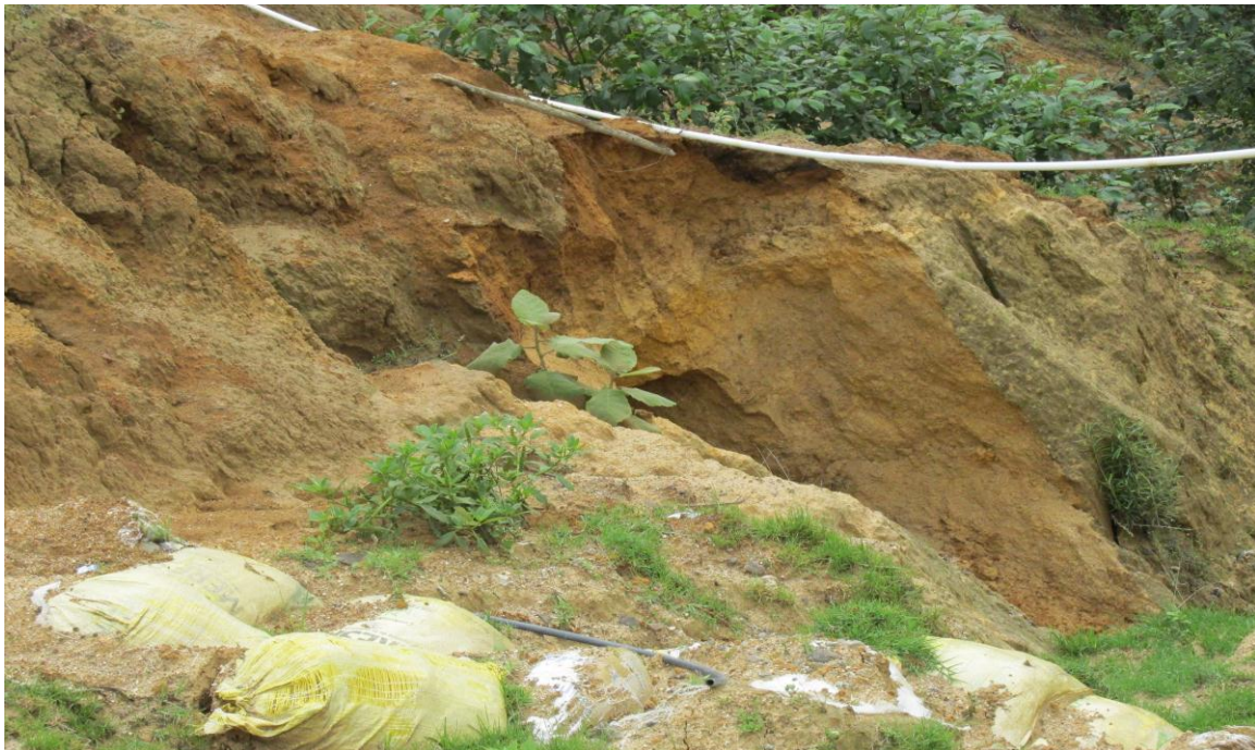
3.2 Hundimiento en carretera
