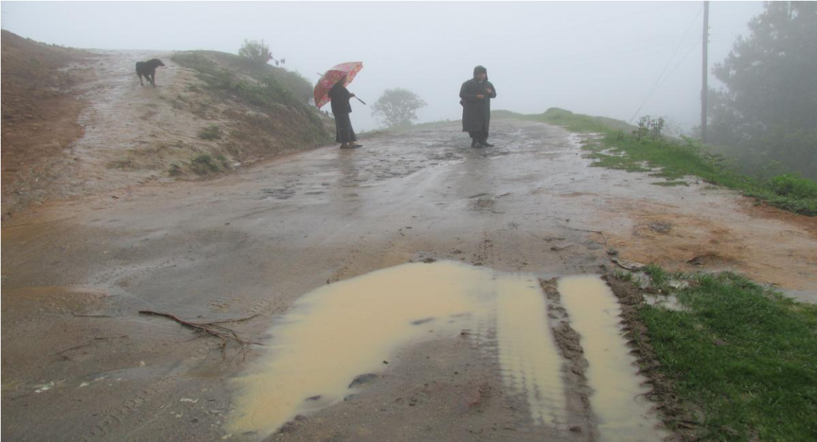
3.3 Carretera de terracería y en mal estado
