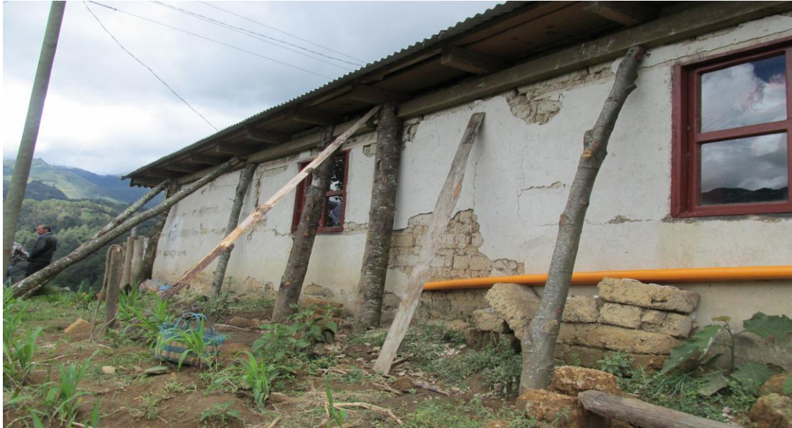
3.1 Construcción de vivienda en ladera y dañada por sismo.
