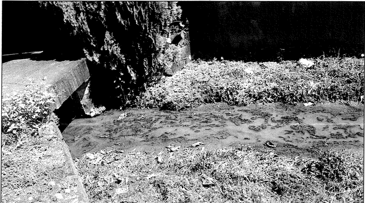
FOTO 6 Municipio de Morales, Departamento de Izabal Falta de drenajes
