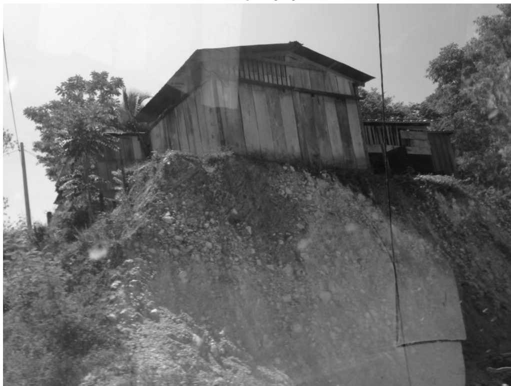
Imagen 2 Municipio de La Libertad, Departamento de Petén Riesgo de Derrumbe Caserío Buenos Aires Año: 2015
