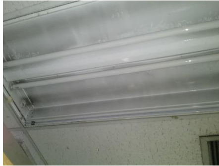
Imagen 2 Lámparas descompuestas de cocineta
