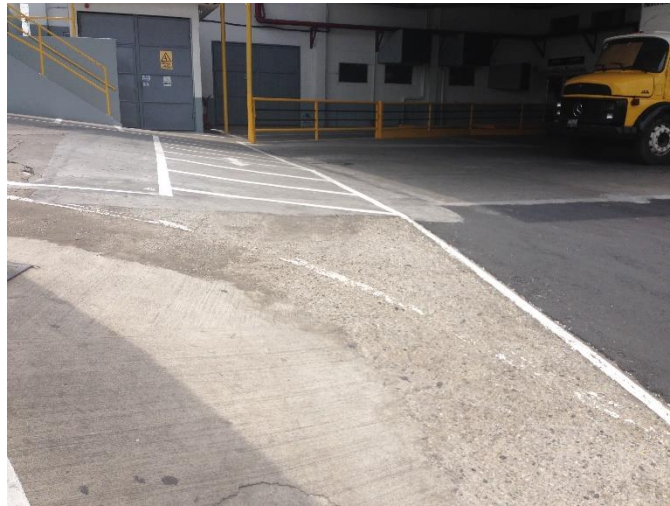
Figura 21, señalización en rampa de cafetería
