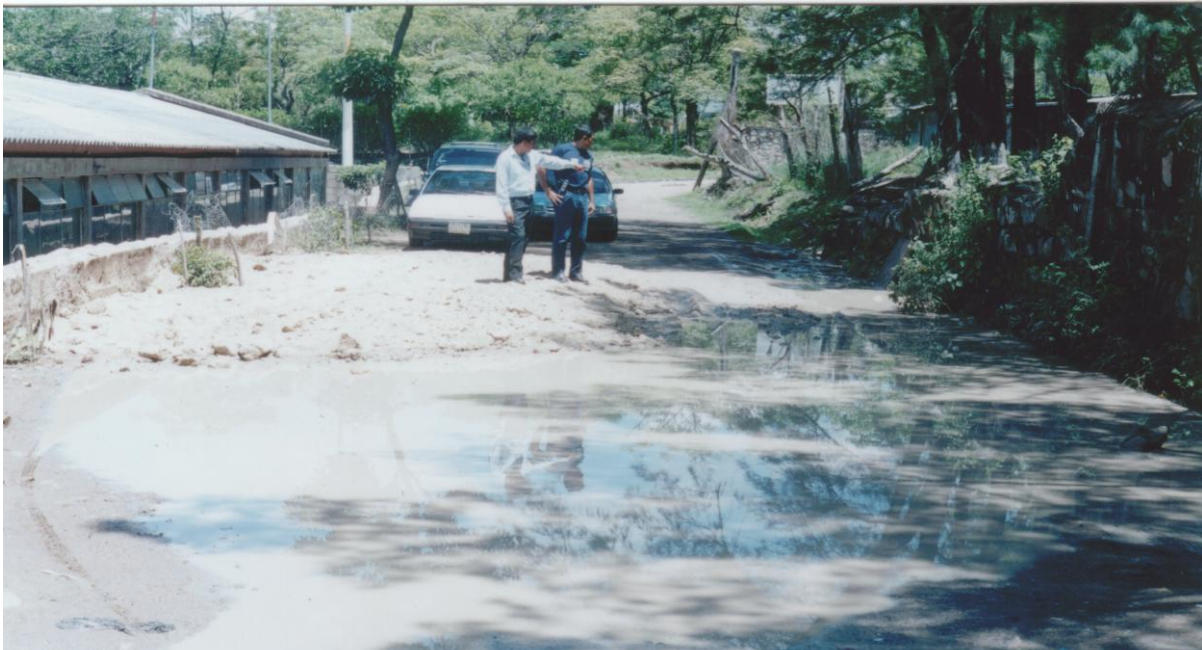
Se observa el deterioro que sufría la calle en periodo de invierno donde siempre se formaban charcos, lo que dificultaba siempre el paso peatonal y vehicular.
