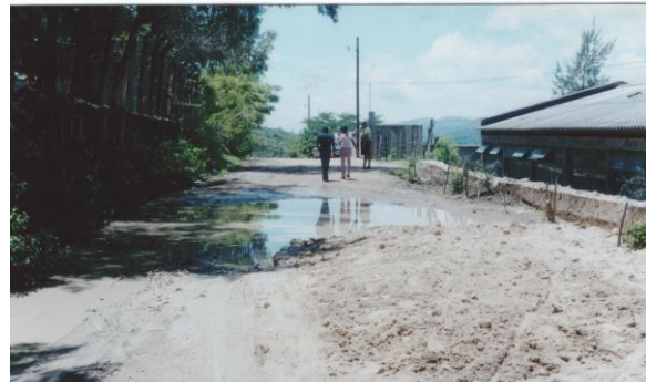
En esta fotografía se observa la calle en malas condiciones
