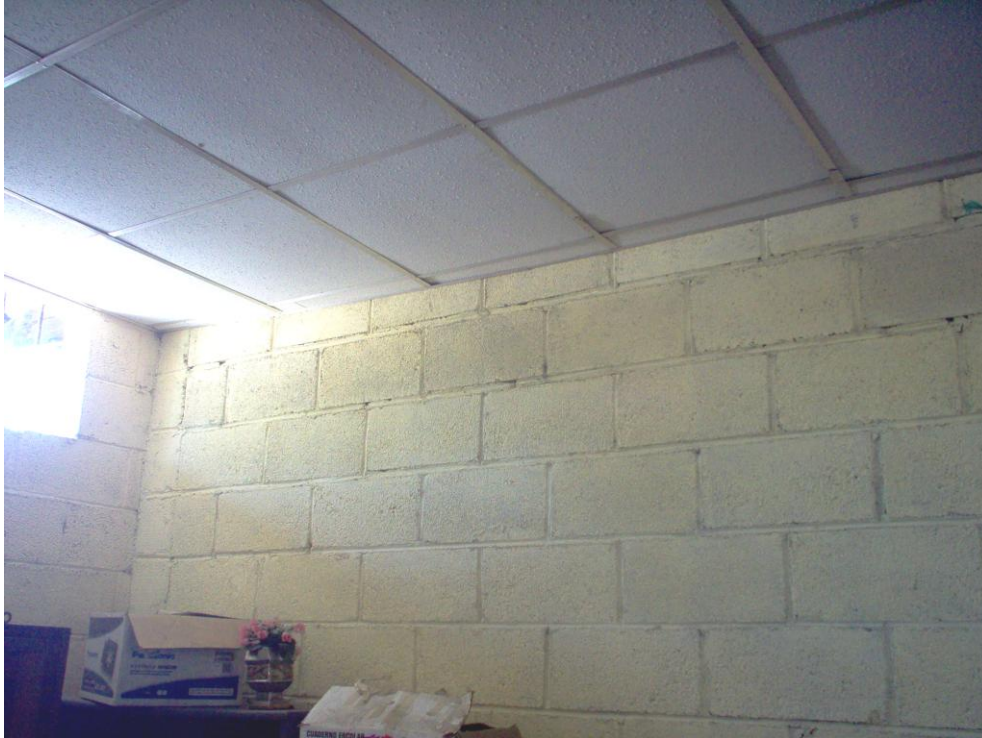
Pared limítrofe construida en la Supervisión Educativa de la Dirección Departamental de Educación de Chiquimula.
