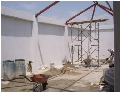
Fig. 51 Evolución en la construcción de la Biblioteca escolar Foto: Bib. Dora María Cardoza
