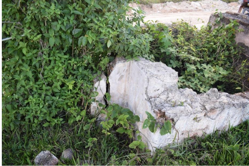
Imagen No. 5, Primera Caja de agua, sirve de basurero, gran parte está destruida. (Agustin 2018 )
