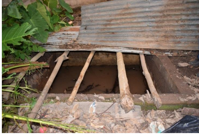
Imagen No. 36, restos del tanque de rebalse a tres cuadras de la pila de distribución (Agustin 2018 )
