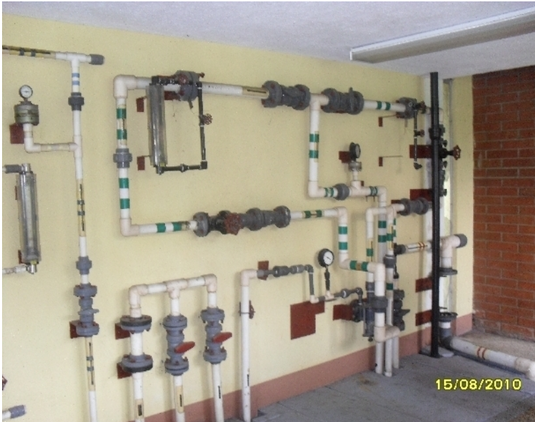
Tubería de la planta de tratamiento Lo de Coy Mixco
