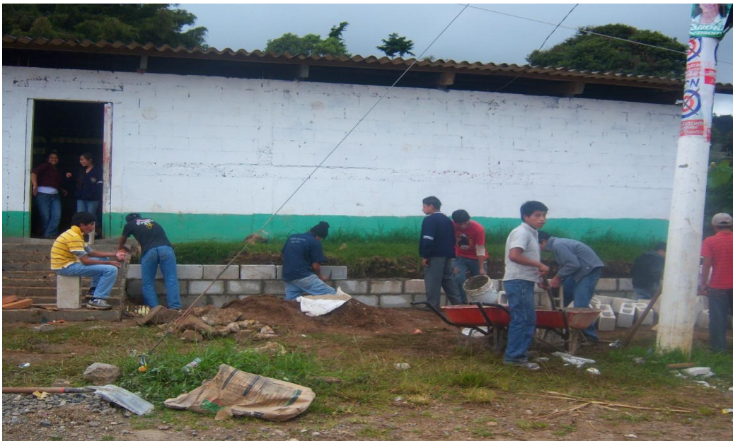
Foto. Se Observa a los jóvenes trabajando en la construcción de la jardinera.
