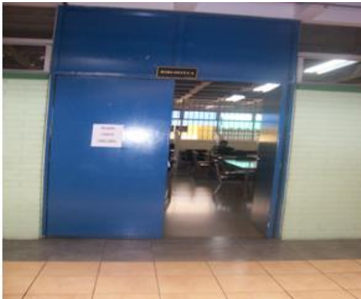
Fotografía 1 Puerta principal en mal estado
