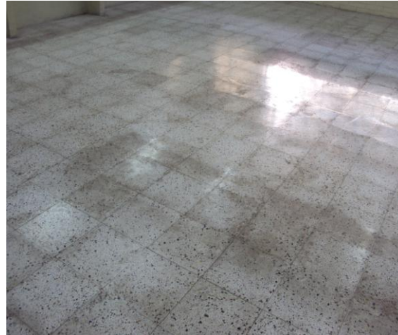
Fotografía 7 Aquí se observa el piso manchado
