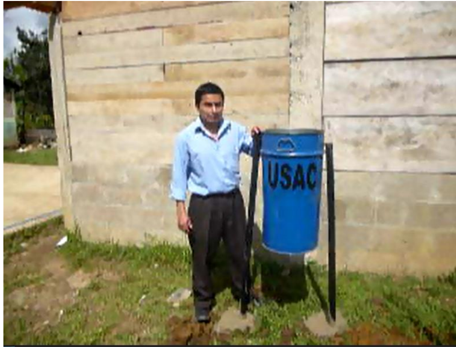
Epesista mostrando colector de basura instalado y sellado con mortero de concreto compuesto de arena de fundición y cemento, para su fijación en el suelo.
