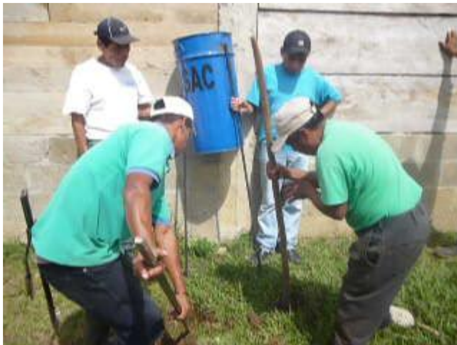
Instalación de los colectores de basura en puntos de mayor concentración de personas de la comunidad.
