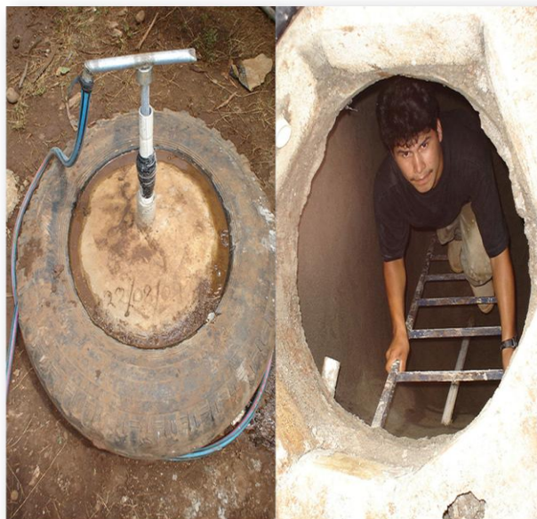
Imagen 45: Bomba EMAS y cisterna de almacenamiento artesanal.
