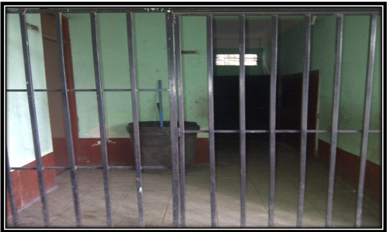
Al fondo están los baños y también carecen de iluminación y ventilación
