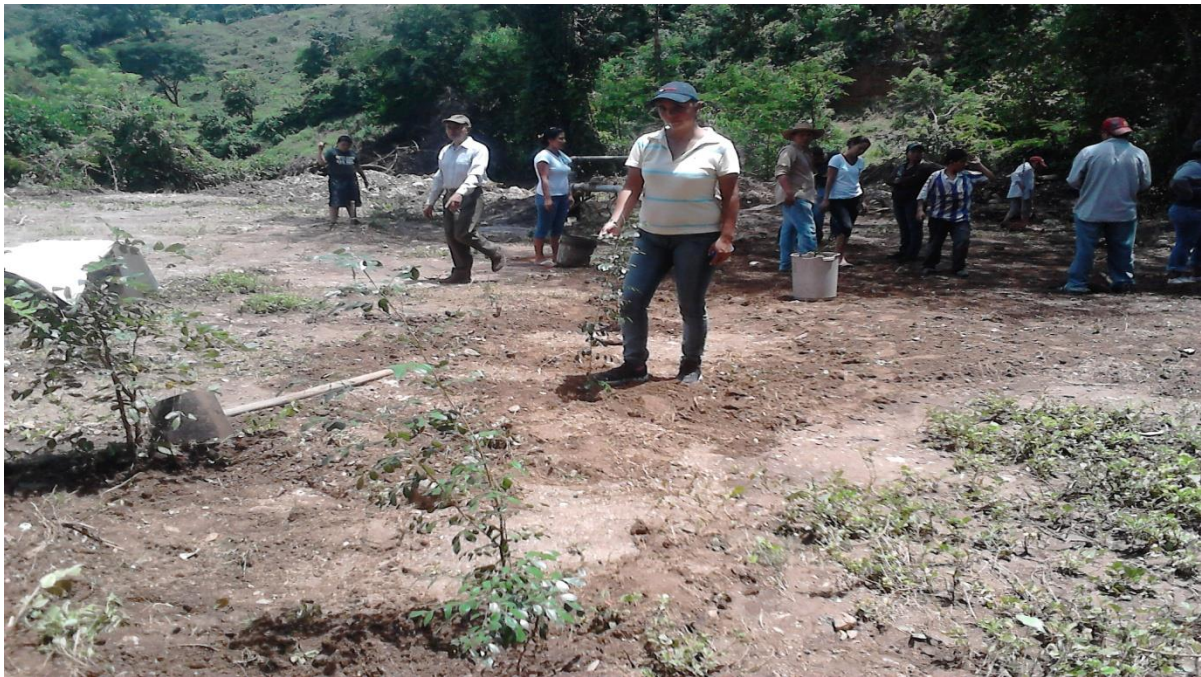
Epesista PEM. Deisi Maribeli Ruano Vicente en trabajos de construcción del Macro proyecto Parque Ecológico, El Porvenir San Diego, Zacapa
