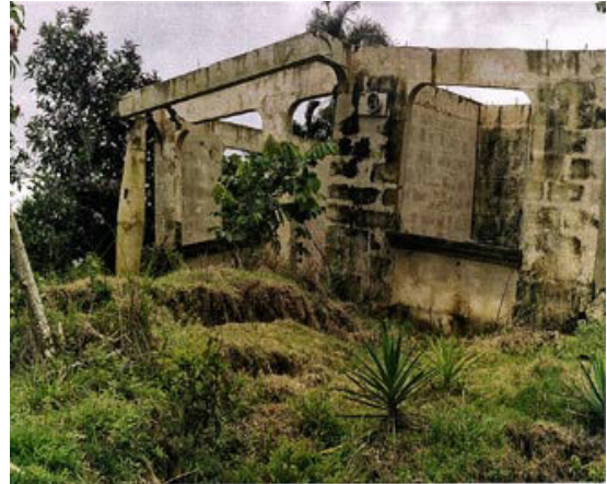
Pisos agrietados, paredes inclinadas
