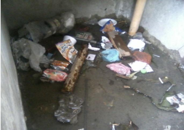
Pileta con agua estancada por falta de salida
