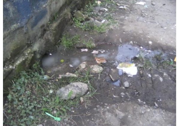
Aguas servidas a flor de tierra
