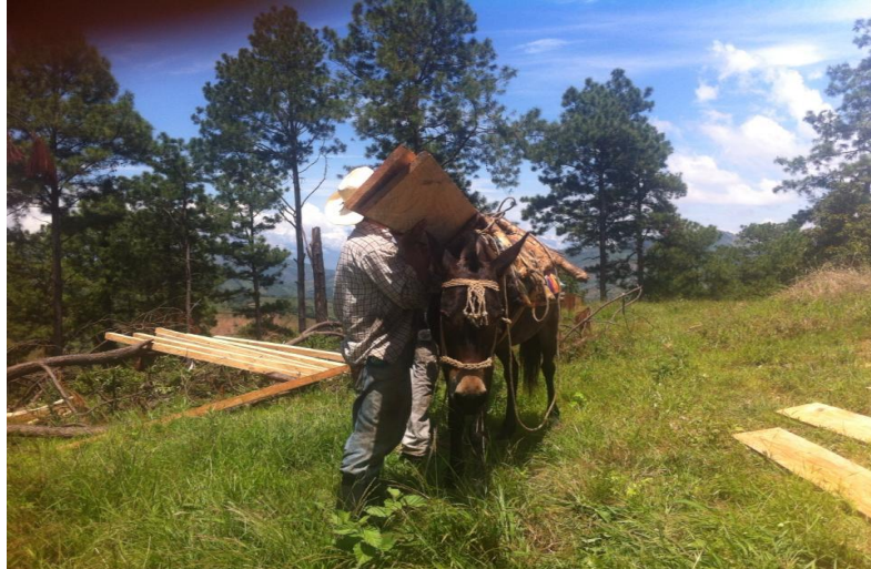
Foto tomada en el bosque el Pitajallo al momento de transportarla, El porvenir, San Diego, Zacapa.
