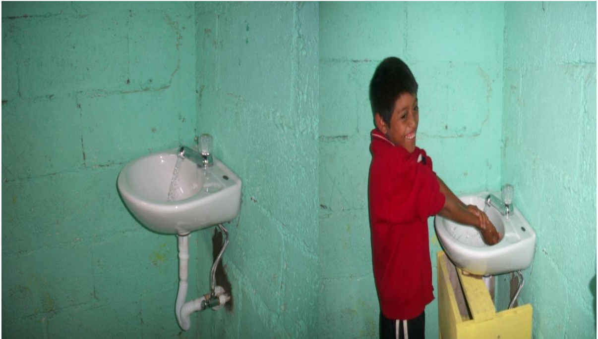
Lavamanos instalados en los sanitarios del centro educativo, para que los niños puedan practicar el hábito de lavado de las manos.
