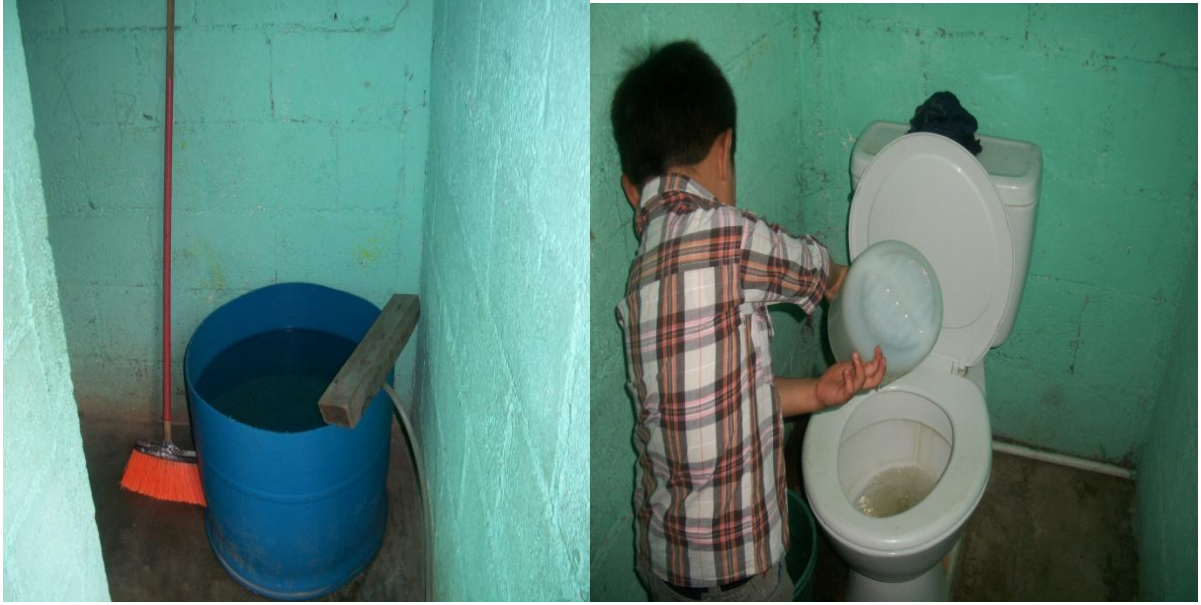
Condiciones de insalubridad en los sanitarios del centro educativo antes de instalar el depósito de agua.
