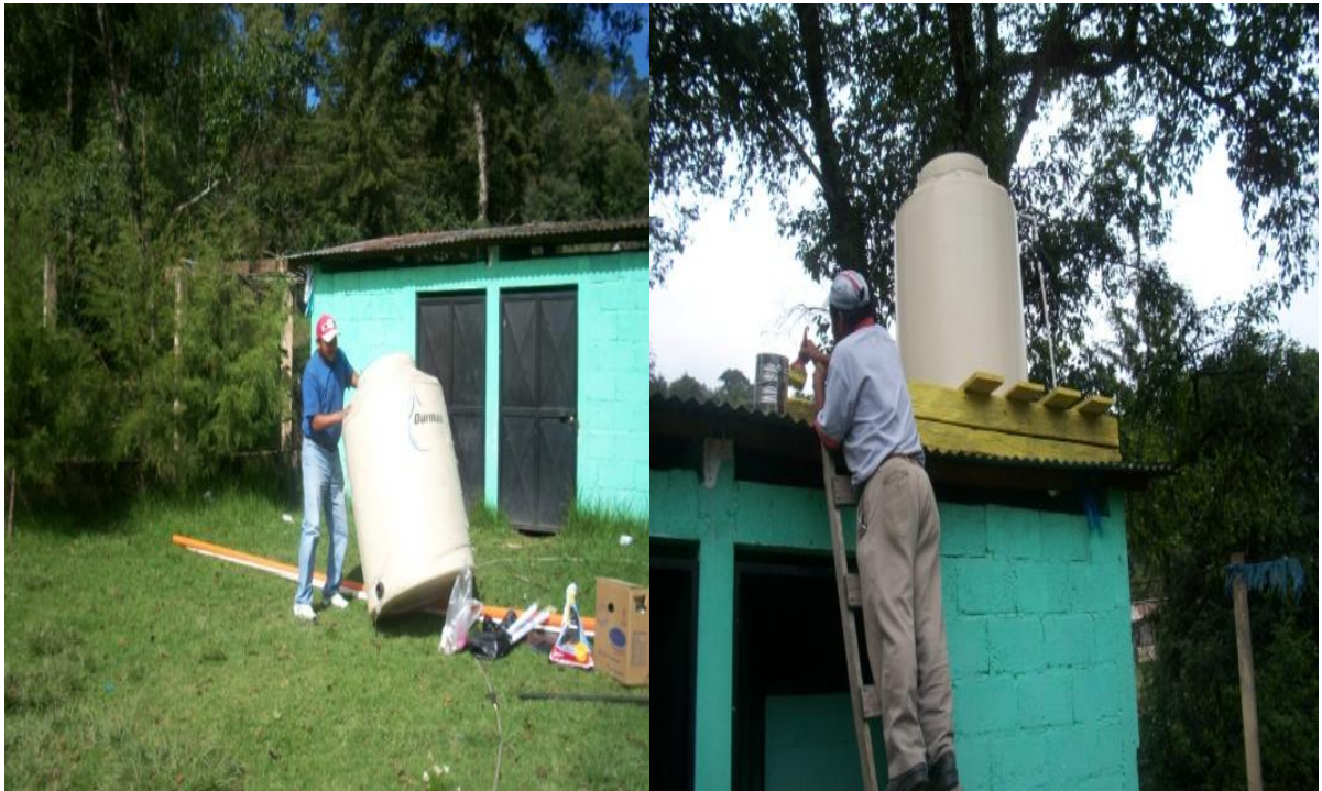
Depósito para agua instalado en los sanitarios del establecimiento, con colaboración de los padres de familia.
