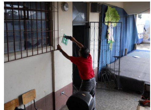
Señalización de ruta de evacuación (Dirección General)
