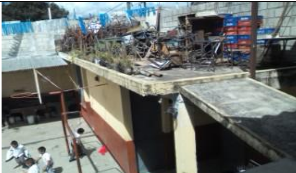
Desechos y material que genera contaminación, acumulados en el techo de la escuela.
