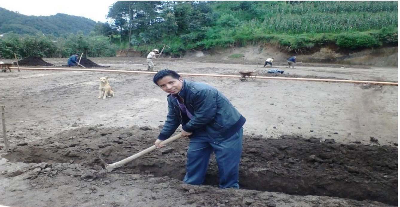
Epesista realizando labores de sanjeo para la colocación de tubos PBC estilo francesa para captación de agua.
