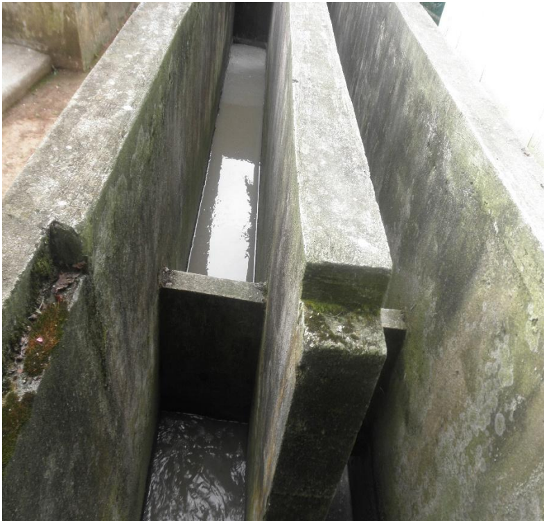
Fuente: Planta de Tratamiento de San Bartolomé M.A. Zona 4. Abraham Arévalo
