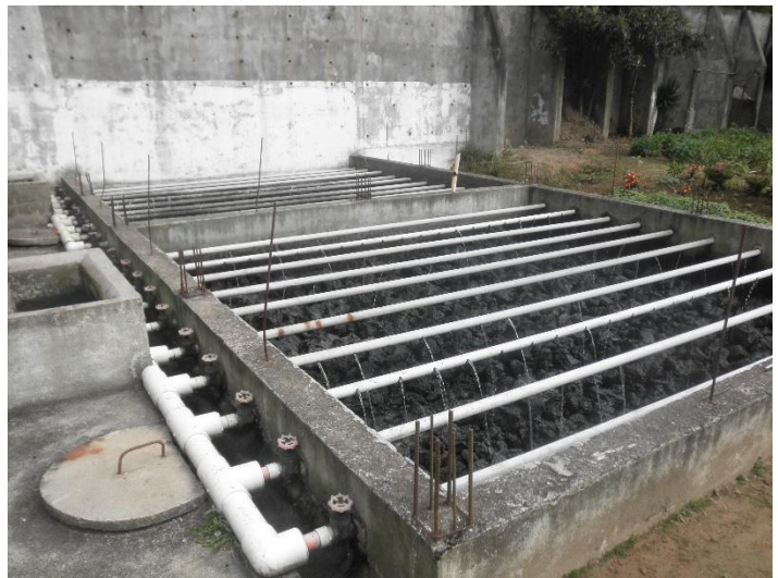
Fuente: Planta de Tratamiento de San Bartolomé M.A. Zona 4. Abraham Arévalo
