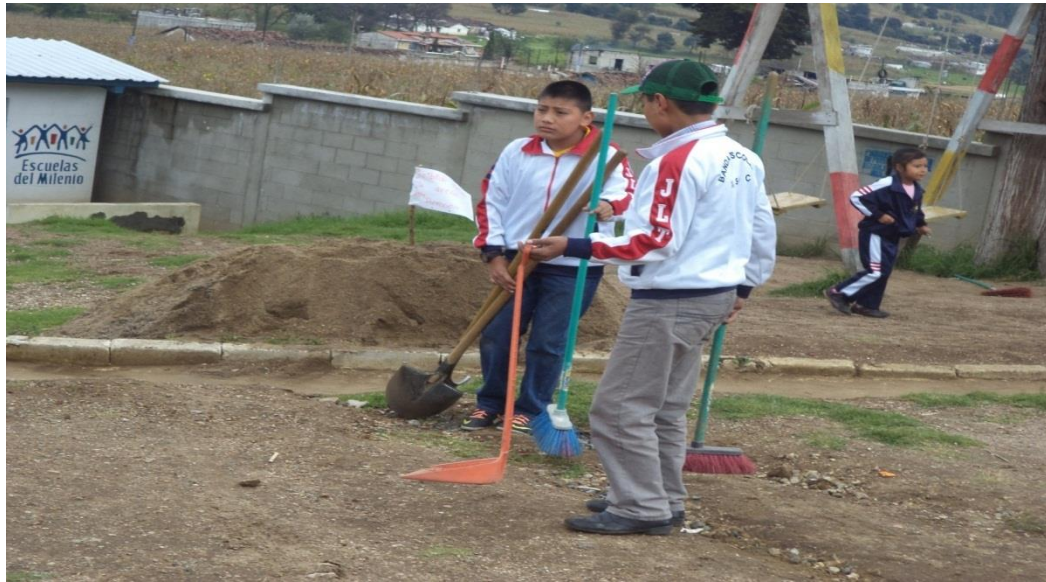
Estudiantes de EORM “José Luciano Tahay”, ayudando a recibir los materiales para la construcción, año 2015.
