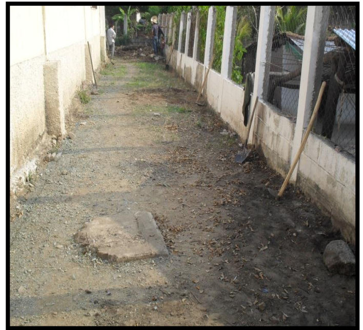
Terminando de limpiar el terreno y se observa la inclinación del muro perimetral.
