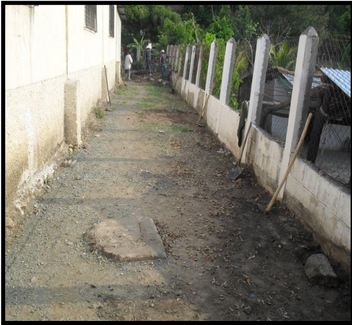
Terminando de limpiar el terreno y se observa la inclinación del muro.
