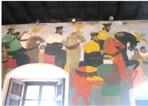
La iluminación artificial de algunas áreas de los murales ya no funciona.
