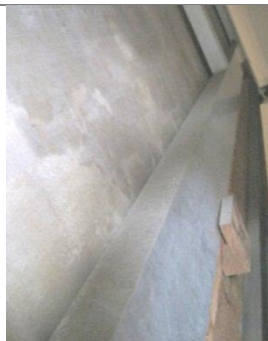
Bastidor con una capa excesiva de polvo
