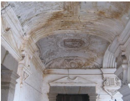
Manchas de humedad en las bóvedas ubicadas en las esquinas de los corredores del edificio.
