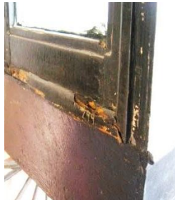
La esquina del marco de la compuerta derecha presenta ataque de carcomas
