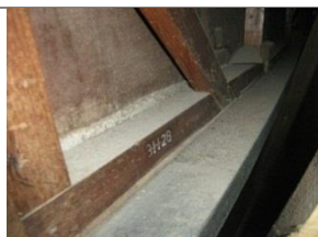
El bastidor de la pintura se encuentra con una capa de polvo
