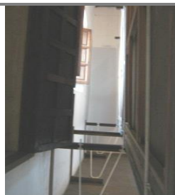
El bastidor presenta una capa excesiva de polvo, en las puertas abiertas están las conexiones eléctricas
