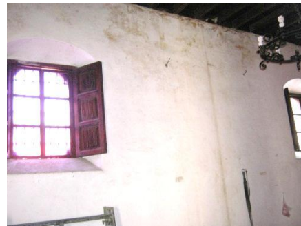
Se observa manchas de humedad en la parte superior de la pared y polvo.
