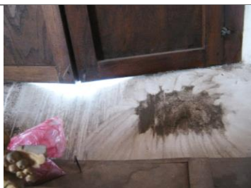
Eliminación del polvo en ventana sobre el Camerín
