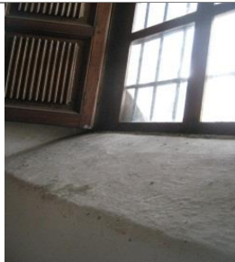
Ubicación de ventana detrás de las pinturas. Se encuentra cubierta de polvo.
