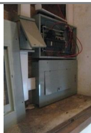
Caja de conexiones eléctricas detrás del cuadro
