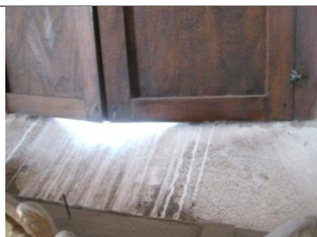
Exceso de polvo en ventana sobre el Camerín y consola
