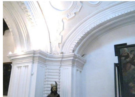
La iluminación artificial en esta área es poca, ya se observan reflectores quemados.
