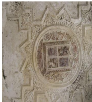
Detalle del escudo real en las bóvedas de esquina en corredores, ya se observa pérdida de capa pictórica por causa de la humedad que existe en el edificio
