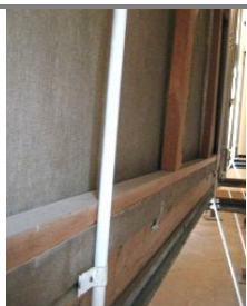
Bastidor de pintura con una capa excesiva de polvo.
