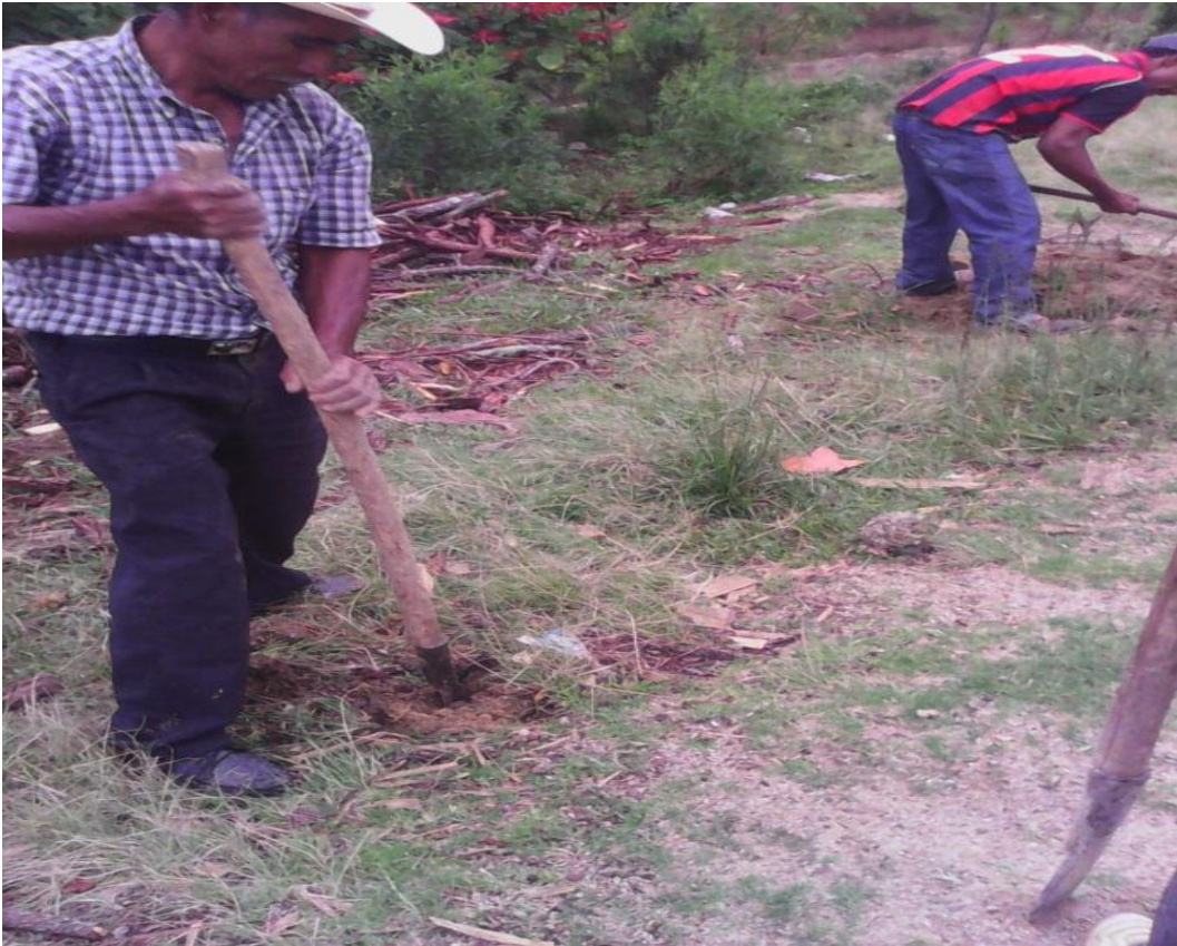
Hoyadas en las orillas de la carretera.
