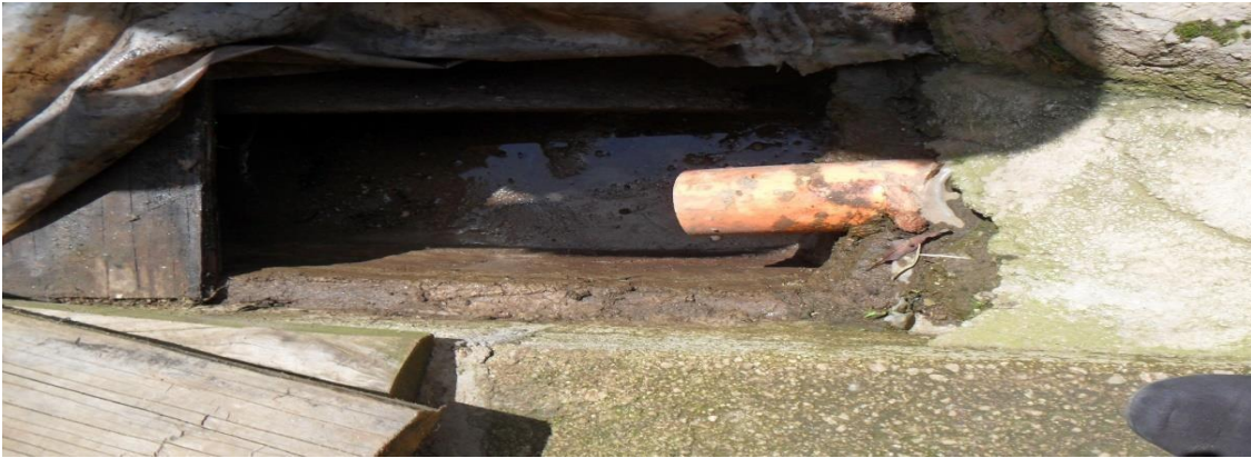
El drenaje estaba dañado y cubierto con madera y nylon.
