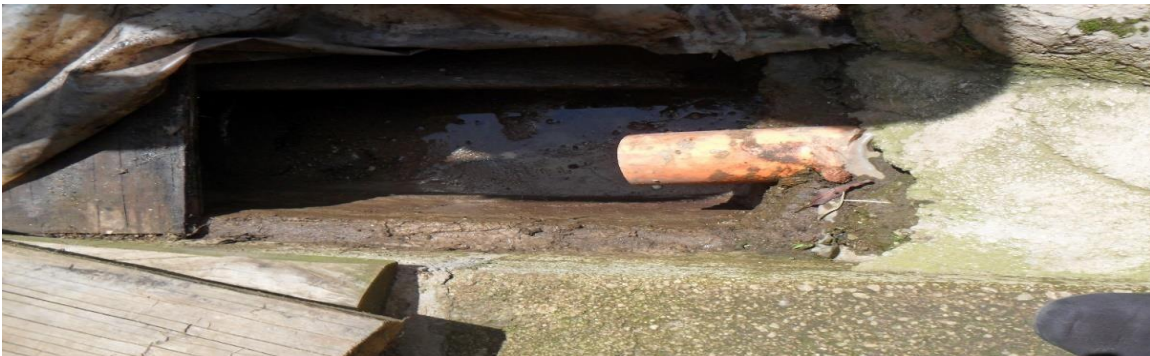
Se puede apreciar as aguas negras que salían del servicio sanitario.
