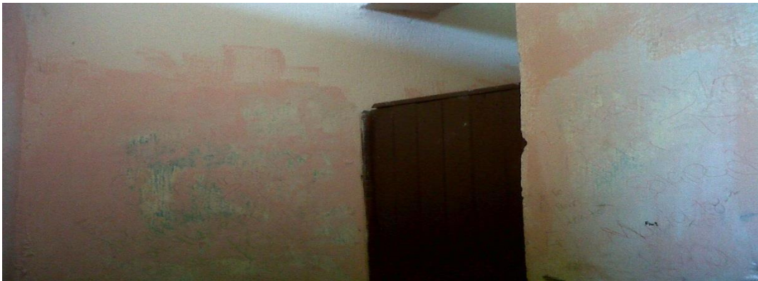
Paredes dañadas rotuladas
