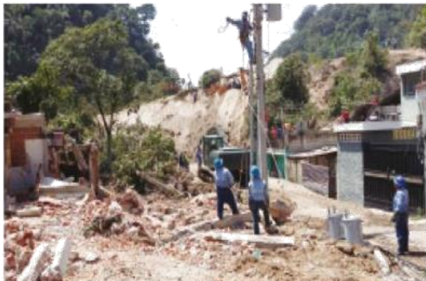
Foto Byron Hernández. Derrumbe en Cambray II, Santa Catarina, Pinula, Guatemala, destrucción y muerte.
