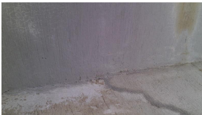
Fuente: Gustavo Amílcar Bracamonte Vargas/Paredes con problemas de humedad
