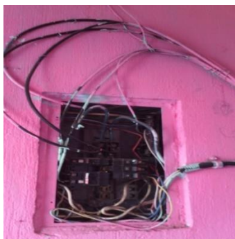
Fuente: Gustavo Amílcar Bracamonte Vargas/Caja con alambres eléctricos
